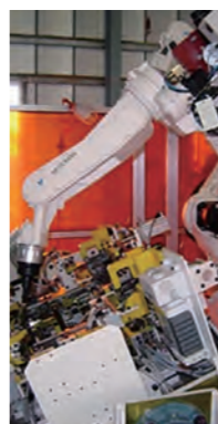
アーク溶接セル(アーク溶接ロボット2台+1軸ポジショナー)
